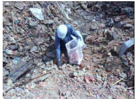
Imagen 5. Vertedero informal de residuos de demolición
